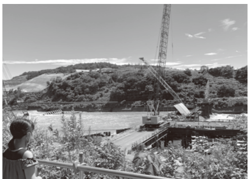
大河津分水路改修事業にともなう山地の堀削や新第二床固の建設の様子
