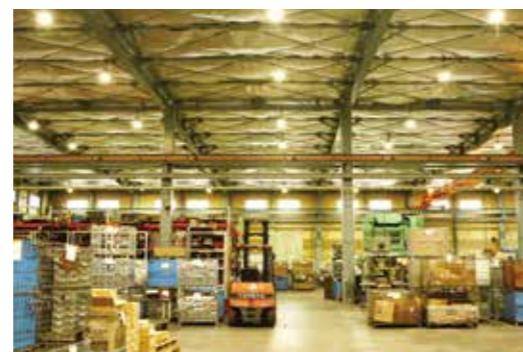
▲導入されたLED照明と遮熱シート
