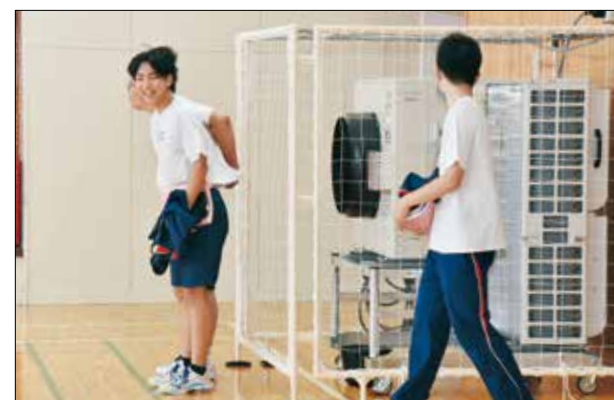
県内初！小中学校体育館に移動式空調機を導入 ●6月7日 吉田中学校
