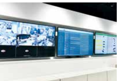
▲工場内に設置してあるモニターには、機械の稼働状況などを表示。生産体制の効率化を図っています。
