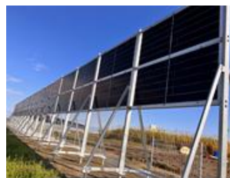
下水終末処理場に導入した太陽光設備
