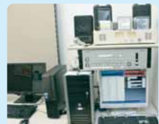
▲放送するための機械
