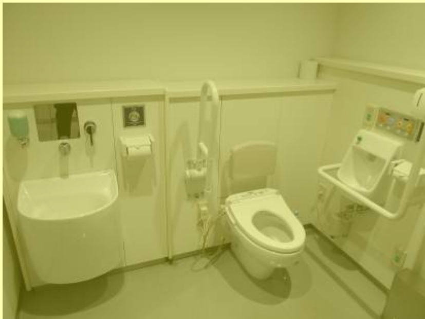
市役所庁舎 多機能トイレ
