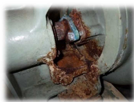
ポンプ設備の発錆
