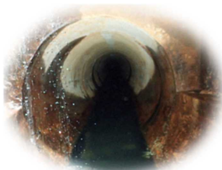
管内状況（漏水）
