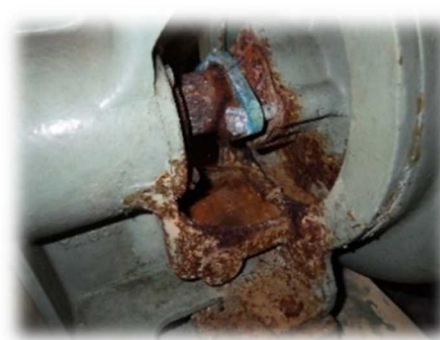
ポンプ設備の発錆
