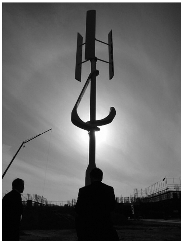
親水公園の照明灯 親水公園には風力と太陽光を利用した 照明灯が5基あります。 蓄えた電力で、公園を照らします
