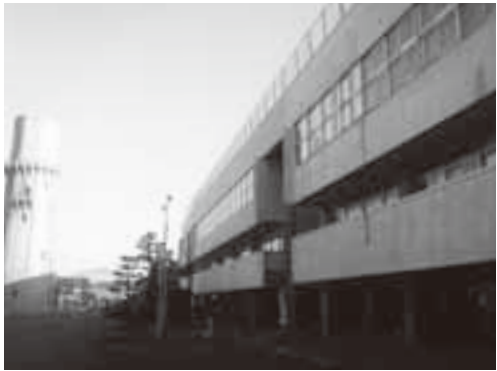
老朽化が進む公共施設
