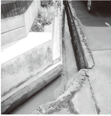
老朽化した燕地区日之出町側溝
