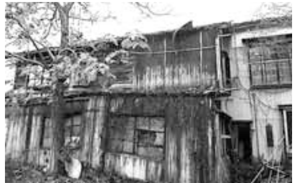
管理不全建物の放置は、周辺住民の生命財産を脅かす
