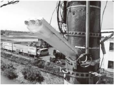
取り付けられたLED防犯灯
