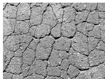
老朽化で地割れしているアスファルト市道
