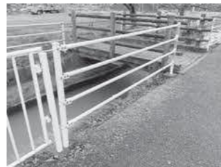
危険な「みなみ親水公園」の橋付近の横柵
