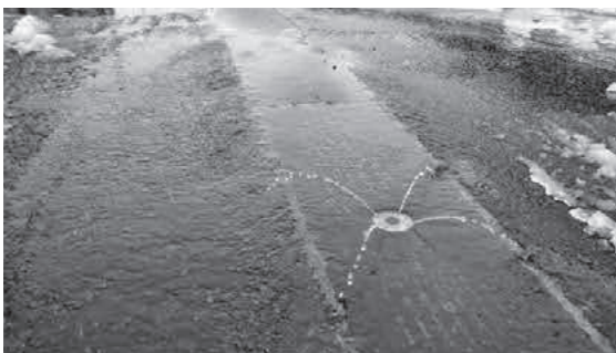
老朽化が進むインフラの維持が全国的に大きな課題となっている
