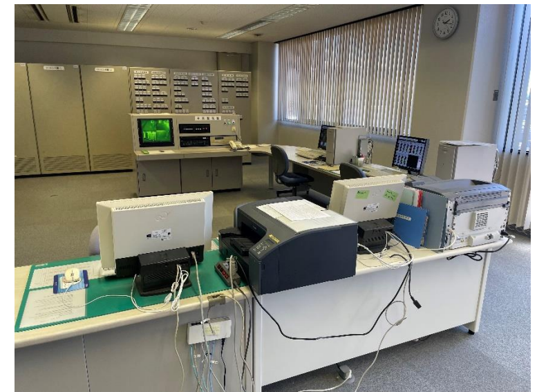
監視制御システム
