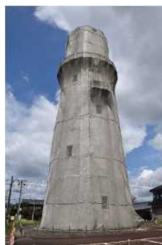
剥落防止ネットで覆われた水道の塔
