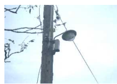
防犯灯(水銀灯)
