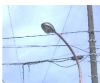
交差点照明(水銀灯)
