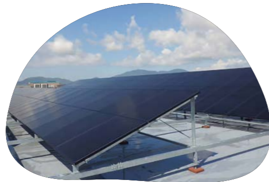
市内に設置された太陽光パネル
