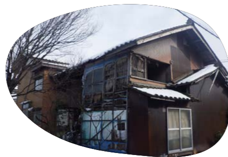
著しく危険な状態となった特定空き家
