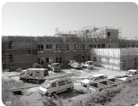
▲建設中の特別養護老人ホーム「さわたりの郷」。敷地面積 6,444.88㎡ 鉄筋コンクリート造り一部3階建て、延床面積 5,322.51㎡ (9/21撮影)
