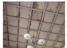
天井に雨漏り痕がありますが屋根の修繕済みです。
